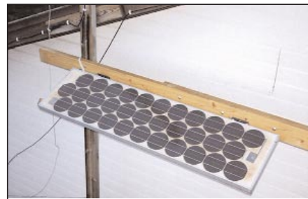
Obr.2 Můj PV panel Arco 32-W je umístěn na jižní stěně, kde nic nemůže slunce zaoclonit. Pro zajištění nejlepší funkce nastavuji rameno pod panelem a několikrát do roka tak měním úhel náklonu. Panel je připraven na horizontální liště na závěsech, aby se dala snadno měnit jeho poloha.
